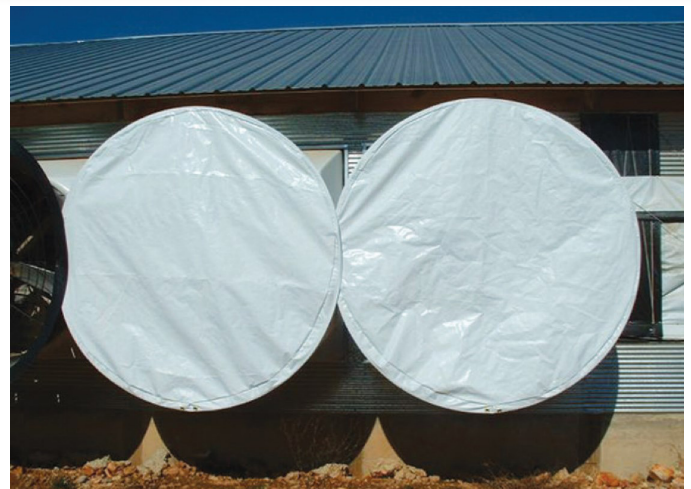
Чохли для вентиляторів запобігають потраплянню холодного повітря в приміщення
