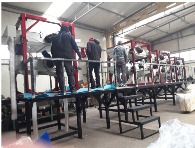
Рис. 77. Ця частина лінії калібрування насіння (двоюрисна компоновка) за час нашої публікації проєкту СИЛЬНЕ НАСІННЯ™ вже встановлена та введена в експлуатацію на насінневому заводі в Молдові
