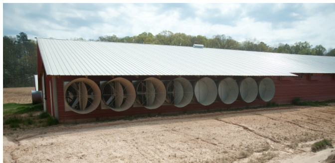
Фото 2. Тунельні вентилятори на бічній стіні пташника
